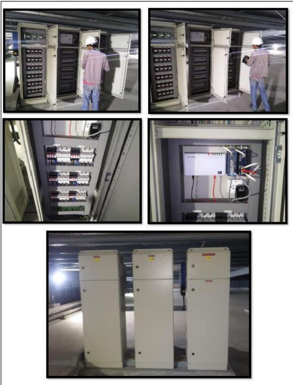
รูปภาพประกอบการปฏิบัติงาน ตรวจสอบความเรียบร้อย และความสะอาดตู้ SCADA
