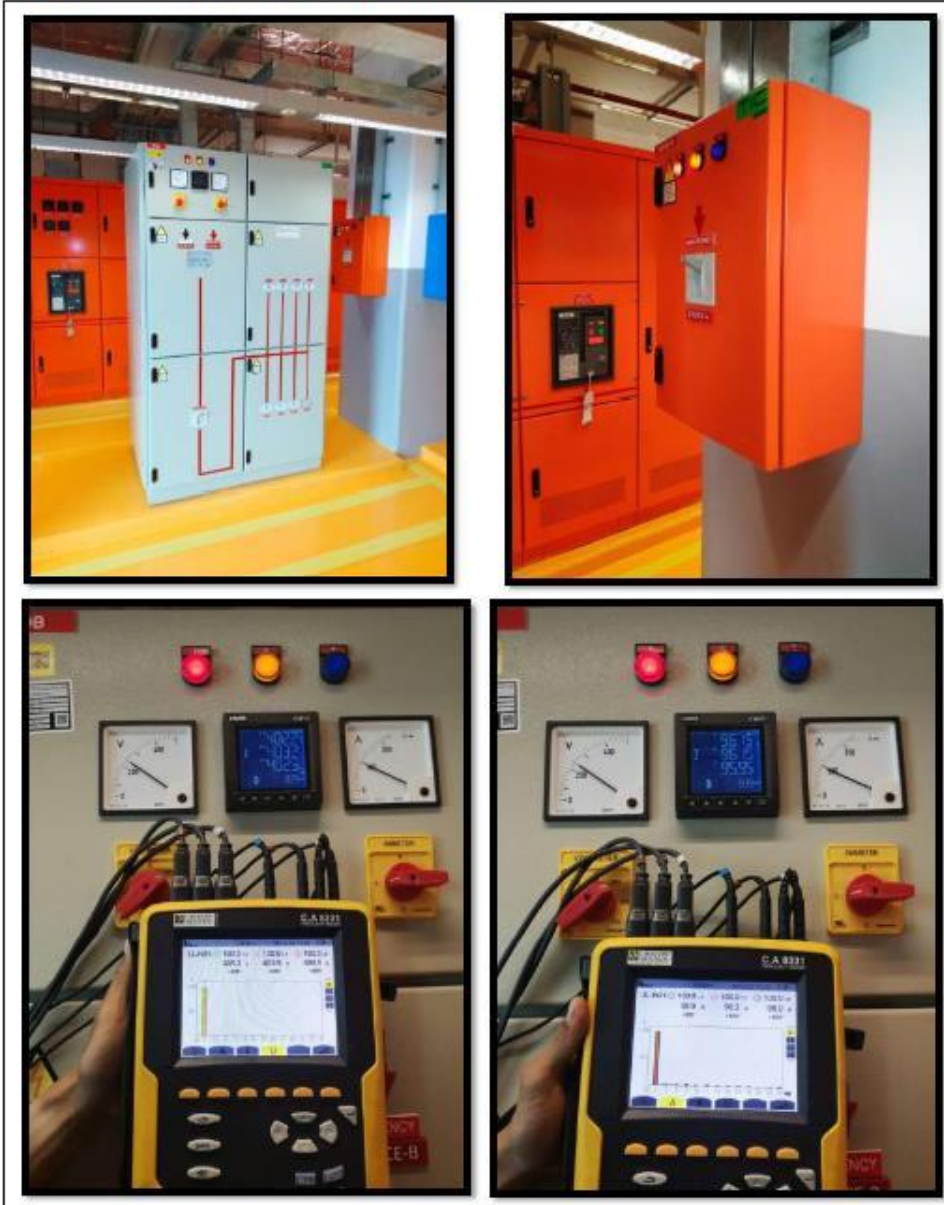
รูปภาพประกอบ ตรวจสอบวัดค่าพลังงานไฟฟ้า (วัดเทียบ) AC, DC
