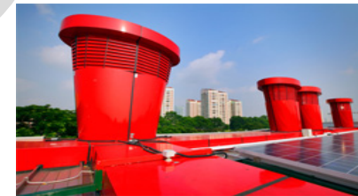
รูปที่ 13 : Solar stack ventilation system at ZER building , Singapore (BCA,2010)
