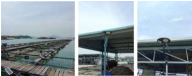
ไฟแสงสว่างบริเวณฟาร์มเลี้ยงมุก
