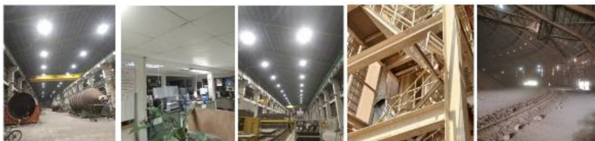
การเปลี่ยนอุปกรณ์ไฟฟ้าแสงสว่างเพื่อเพิ่มประสิทธิภาพ
