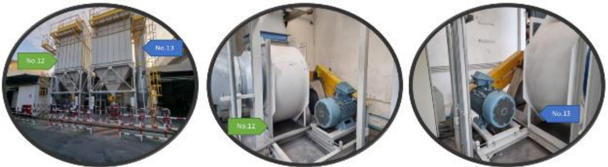
การติดตั้ง VSD ควบคุมความเร็วมอเตอร์
