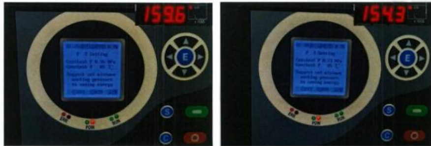
ภาพก่อนการปรับลดแรงดันระบบอัดอากาศ
