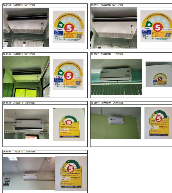
ภาพถ่าย เครื่องปรับอากาศ Inverter 7 เครื่องที่ติดตั้งแล้ว
