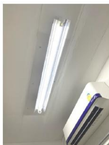
หลอดชนิด LED 18W ห้องไฟฟ้า
