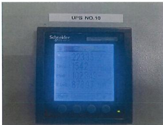
Power Meter ที่ตรวจค่าการใช้พลังงาน Schneider PM2200
