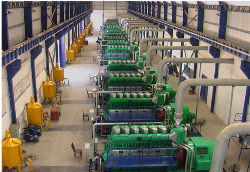
รูปที่ 2.9.3 โรงไฟฟ้าดีเซล
