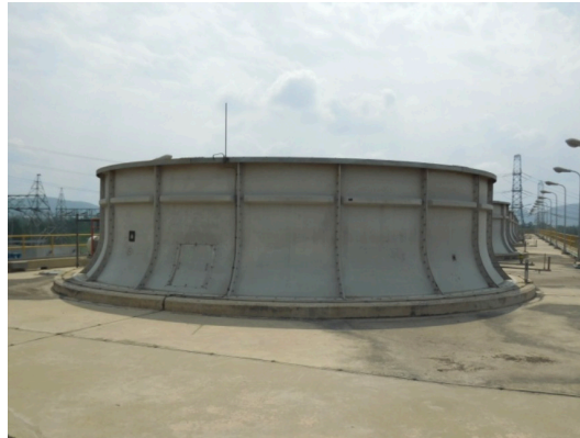
ระบบระบายอากาศของหอหล่อเย็น
