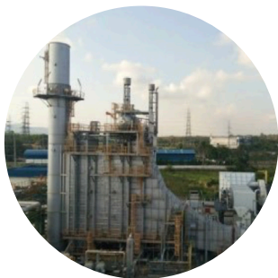
ก) Waste Heat Recovery Unit ในโรงไฟฟ้า พลังงานความร้อนร่วมชนิด Combined Cycle
