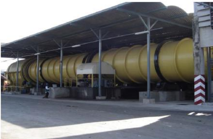
ถังหมักมูลฝอย (homogenization drum)
