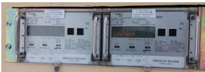
มิเตอร์วัดปริมาณไฟฟ้า
