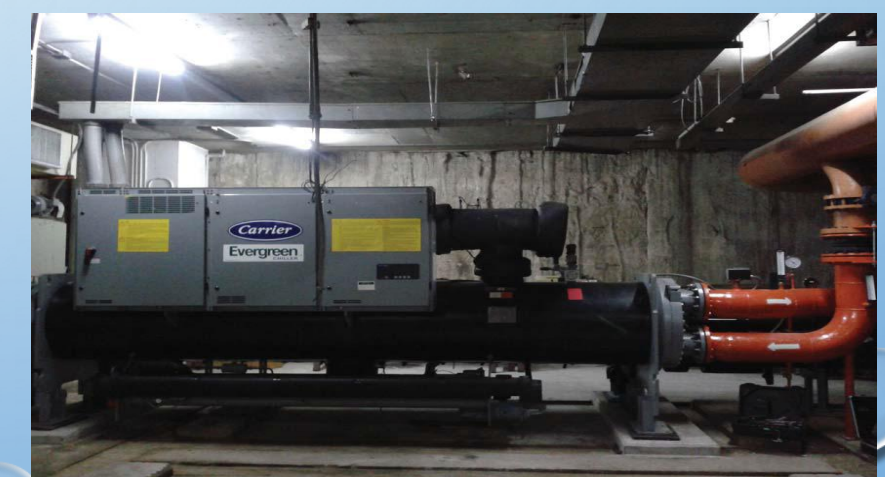
Site Ref. : เครื่องทำน้ำเย็นชนิดปรับความเร็วรอบของคอมเพรสเซอร์ Capacity: 500 ตัน
