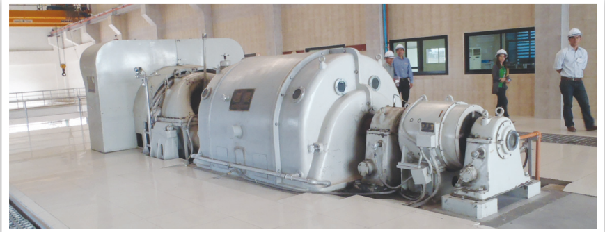
รูปที่ 4.19 โรงไฟฟ้าชีวมวล (Boiler และ Turbine & Generator)
