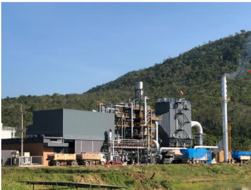
โครงการโรงไฟฟ้าชีวมวลขนาด 4.9 เมกะวัตต์ ของบริษัท ชุมชนพลังงานสะอาด จำกัด จังหวัดพิษณุโลก
