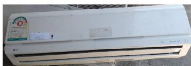
เครื่องปรับอากาศแบบเดิม
