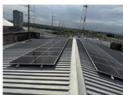
Solar Rooftop บนหลังคา อาคารสถานีไฟฟ้า
