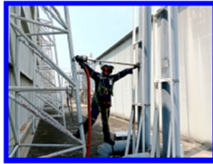
พื้นที่ตรวจวัด : โรงงาน 1 / ปล่อง HOOD เคมี
