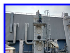
พื้นที่ตรวจวัด : WET SCRUBBER LINE F
