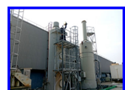
พื้นที่ตรวจวัด : WET SCRUBBER LINE G
