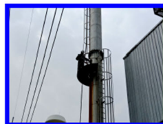
พื้นที่ตรวจวัด : โรงงาน 1 / BOILER No.3 (10 Ton)
