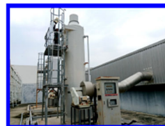
พื้นที่ตรวจวัด : WET SCRUBBER LINE B
