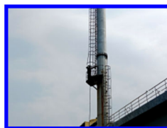
พื้นที่ตรวจวัด : โรงงาน 2 / BOILER No.4 (15 Ton)
